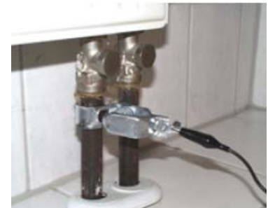
Abbildung 4: Erdung über Erdungsklammer am Heizungsrohr (Quelle: Gigahertz-Solutions)
