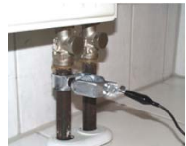
Abbildung 4: Erdung über Erdungsklammer am Heizungsrohr (Quelle: Gigahertz-Solutions)
